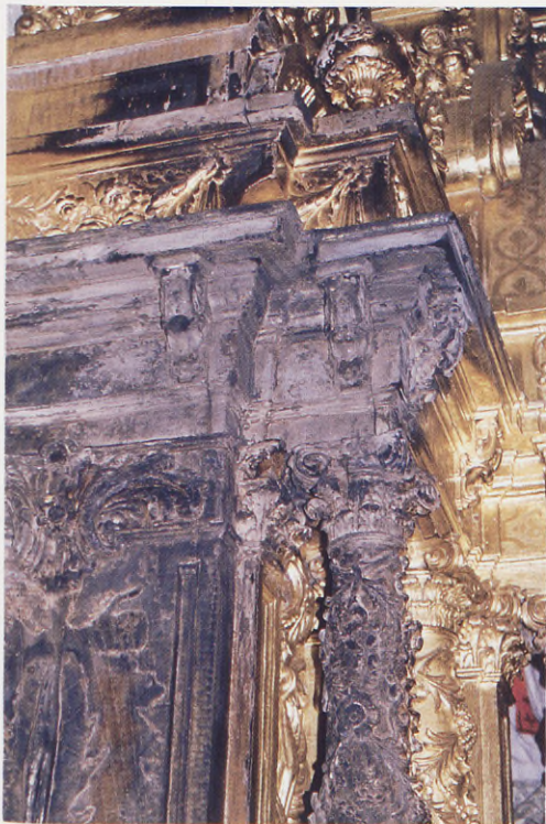
69. Erretaulak erredura garrantzitsuak ditu; oinarria hondatu egin da eta gainazala belztu. Quemadura importante del retablo, con la superficie ennegrecida y pérdidas de soporte.
