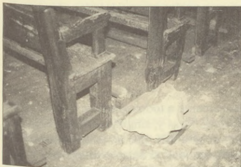
1991-X-21: Bobedatik erori zen dovela. 21-X-1991: la dovela desprendida de la bóveda.
